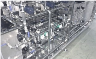
管路系统 Piping system
